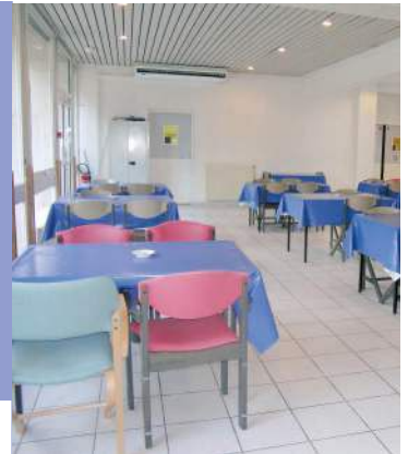
Climatisation de la salle de restauration.
